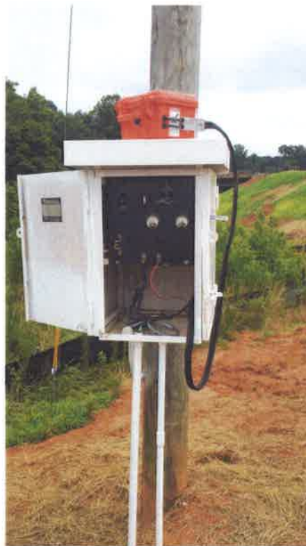
Davis Road Rectifier
