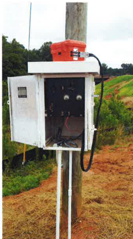
Davis Road Rectifier
